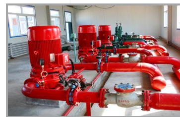
消防泵实时监控
